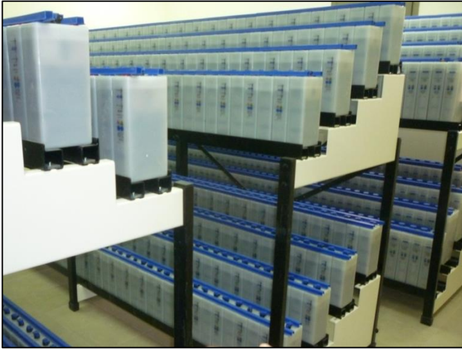
مجموعة بطاريات لزوم المعمل والمبنى ونظام الـ SCADA
