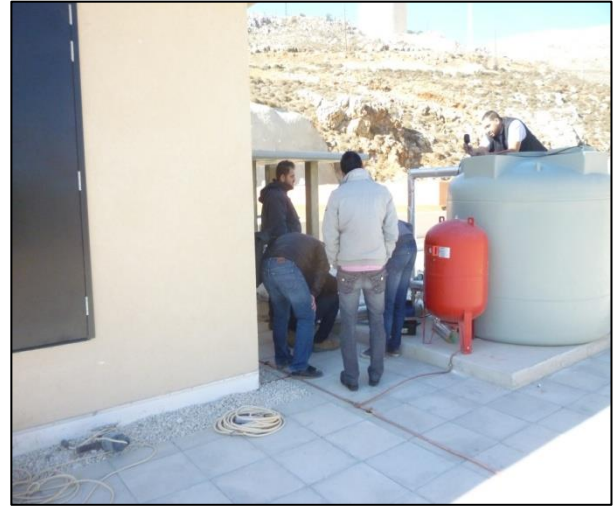
booster pump set على سطح المبنى
