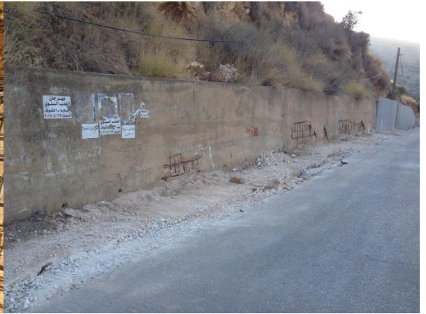
حالة ووضع حائط الدعم قبل التأهيل والترميم
